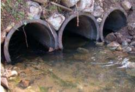
Vertido de aguas residuales
